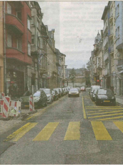
Im unteren Teil der Rue Prince Henri sind die Erneuerungsarbeiten an Fußgängerwegen mittlerweile abgeschlossen. Die Straße soll später zu einem Shared Space werden. Foto: Frank Weyrich, OI
